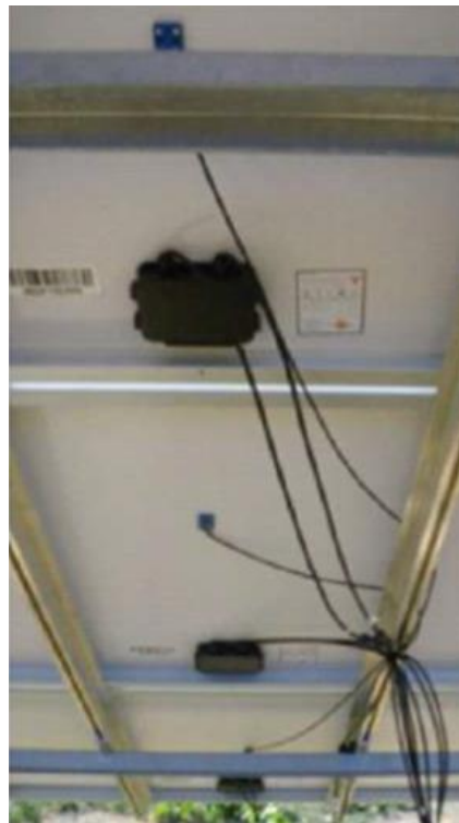
Figure 57 : Câbles des modules
